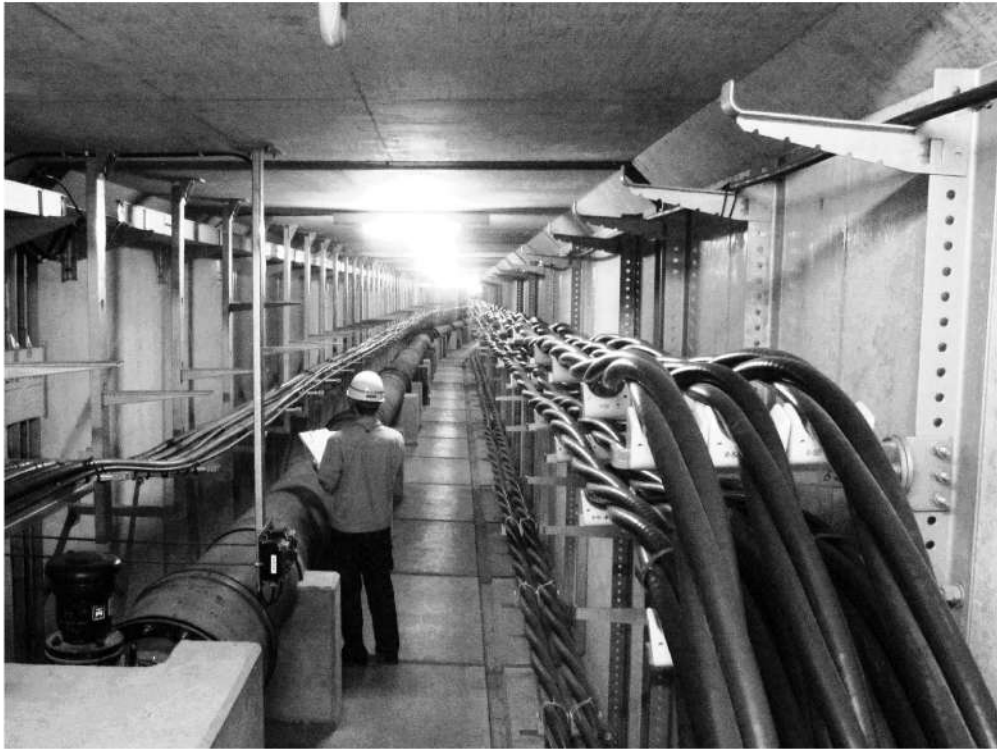
立川共同溝内部
