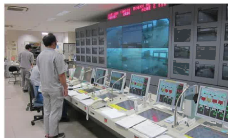
水門管理システム
