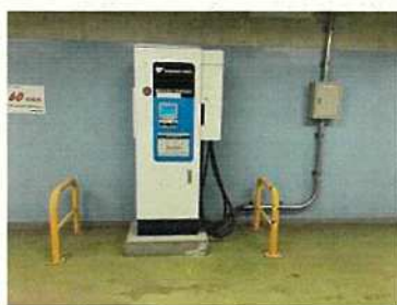
【電気自動車用急速充電器】
